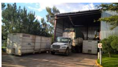
Estación Intermunicipal de Transferencia de Residuos Sólidos que sirve a cuatro municipios de la intermunicipalidad, 2021.
