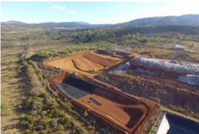
Vista de la construcción de la celda II del relleno sanitario intermunicipal SIMAR Sureste.
