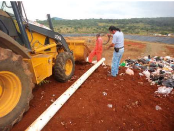
Cobertura y compactación de residuos sólidos y colocación de tubos de biogás en el relleno sanitario intermunicipal
