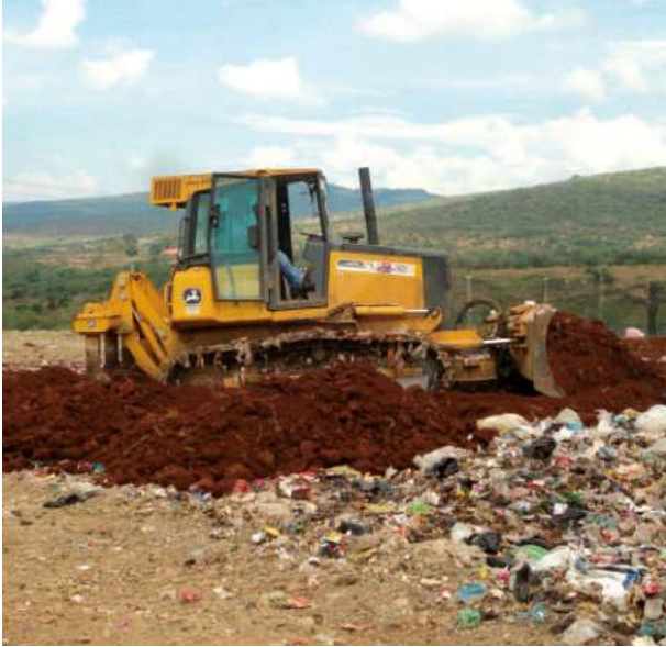
Operación de compactación y cobertura de residuos sólidos en el relleno sanitario
